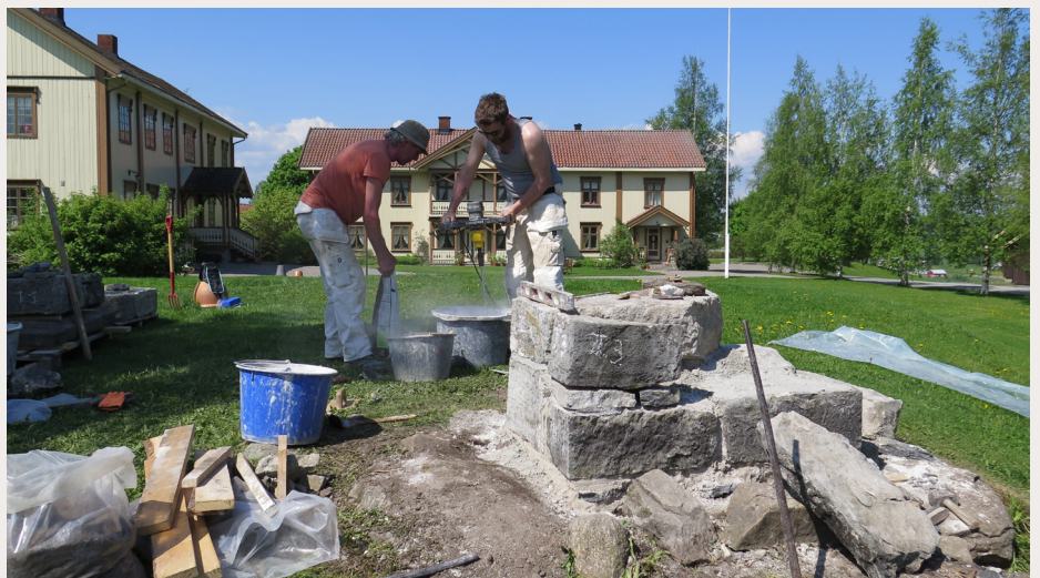
Steinalteret på Dyste under restaurering. Her ser vi murmester Terje Berner og Nils Kristian Høien Nielsen i arbeid. Foto: Inger-Marie Aicher Olsrud, Riksantikvaren.
