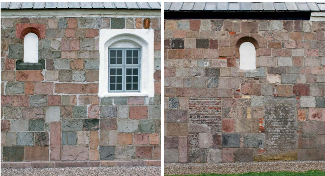
Fig. 15-16. 15. Detalje af skibets sydside med blændet oprindelig dør og vindue samt nyere vindue (s. 1683, 1686 og 1693). 16. Detalje af skibets nordside med blændet oprindelig dør og vindue samt blændet sekundær dør til \ddagger pulpitur (s. 1684, 1686 og 1693). Foto Hugo Johannsen 2012. – 15. Detail von Südseite des Schiffes mit verblendeter ursprünglicher Tür und Fenster sowie neuerem Fenster. 16. Detail an der Nordseite des Schiffes mit verblendeter ursprünglicher Tür und Fenster sowie verblendeter sekundärer Tür zur \ddagger Empore.
